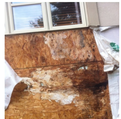
Ossature murale pourrie par infiltration à l'arrière d'un revêtement SIFE en contact avec le papier de revêtement intermédiaire (Boucherville)
