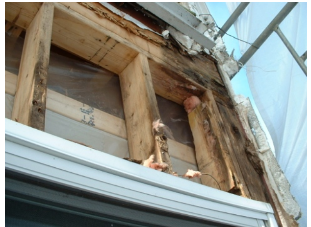
Ossature murale pourrie par infiltration à l'arrière d'un revêtement SIFE en contact avec le papier de revêtement intermédiaire (Montréal-Beaconsfield)
